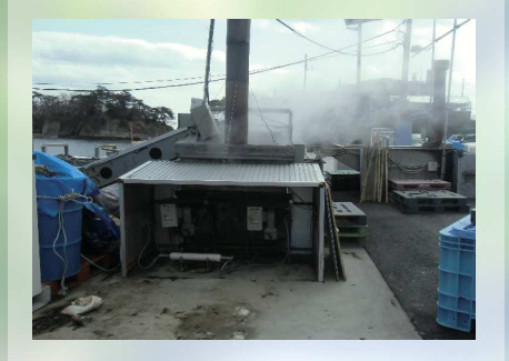
ワカメボイルへの設置状況
